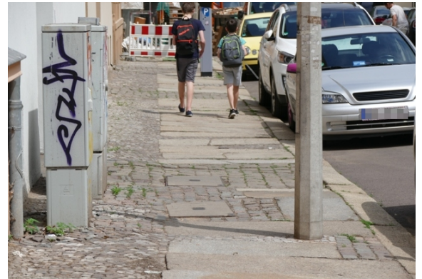
Sanierungsbedürftiger Gehweg in der Puschkinstraße
